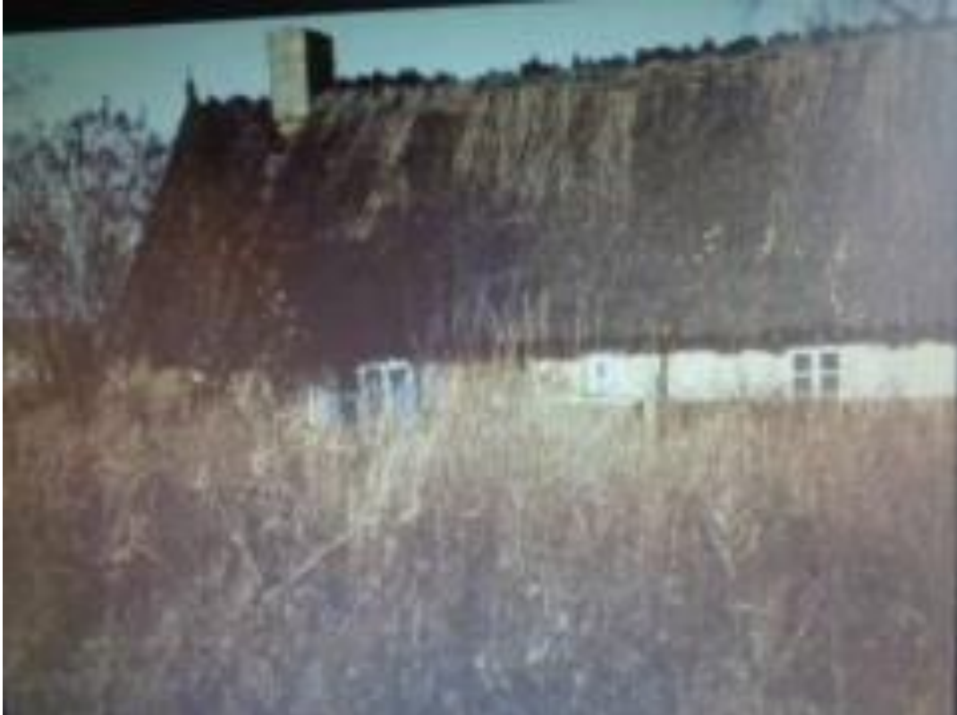
Der Leerstand und der sichtbare Zerfall. Der wohl traurigste Zustand dieses alten Hauses.
